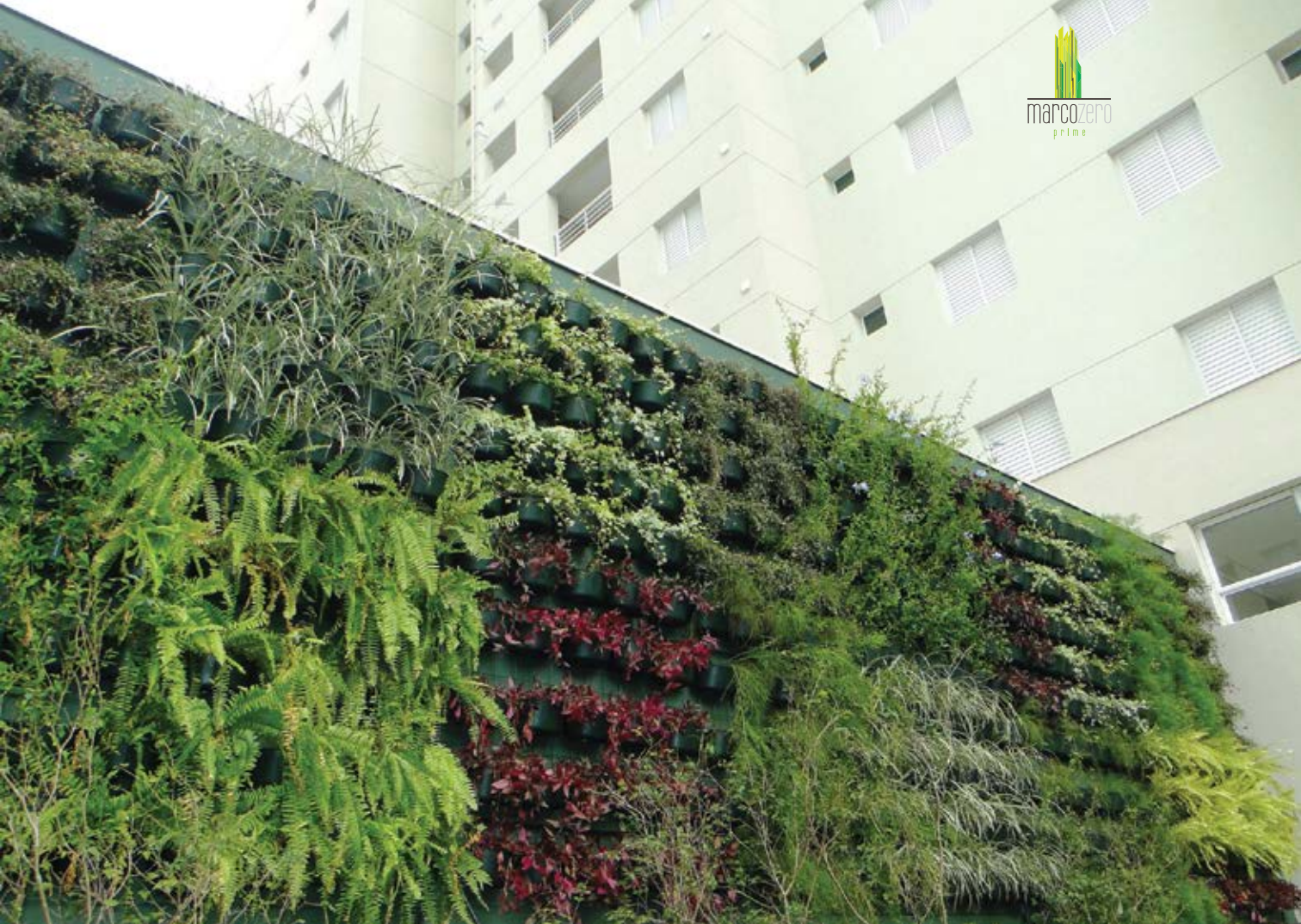
Muro verde com sistema automático de irrigação
